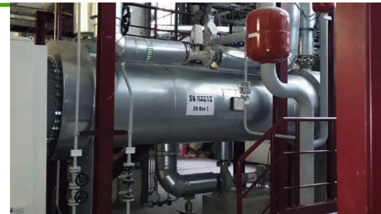
Die Power-To-Heat Anlage der Stadtwerke Schwerin wandelt überschüssige Strommengen elektrisch in Wärme um. Die Stadtwerke Schwerin gehören mit der Inbetriebnahme der drei Elektrokessel am Energiestandort in der Pampower Straße zu den ersten Nutzern Deutschlands, die diese Form der Energiespeicherung zur Entlastung und Absicherung des Stromnetzes anwenden.
