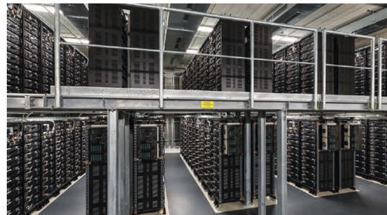
Der WEMAG-Batteriespeicher in Schwerin kann kurzfristige Netzschwankungen, die bei Wind- und Sonnenenergie auftreten können, ausgleichen.
